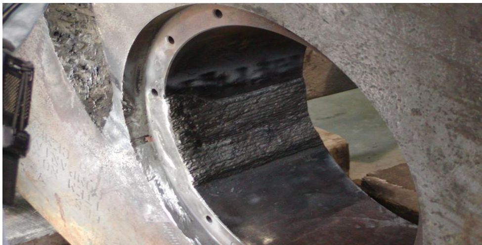
Fig. 2. Zona de desprendimiento de la primera reparación. Fuente: SIE/INDESA
