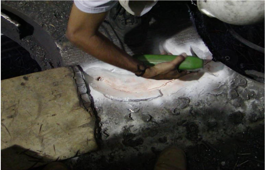
Fig. 5. Inspección por Partículas Magnéticas de las fisuras existentes, antes de iniciar el proceso de soldadura:
